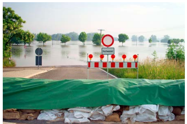
Provisorischer Deich zum Schutz vor Überflutung durch Hochwasser. (Quelle: © PhotographyByMK / Fotolia.com)
