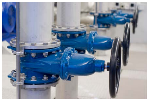
Wasserverteilungsnetze sind lebenswichtige Infrastrukturen, die resilient gestaltet und im Störfall sicher betrieben werden müssen. (Quelle: © iStock.com/prodrive2002)
