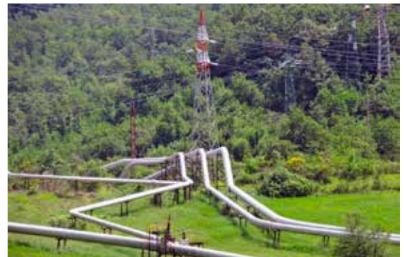
Oberirdisch verlegte Rohre eines Gasnetzes (Quelle: © svitdoll – Fotolia.de)
